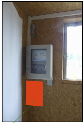
Standort Steuerung: WC-hinter Türe
